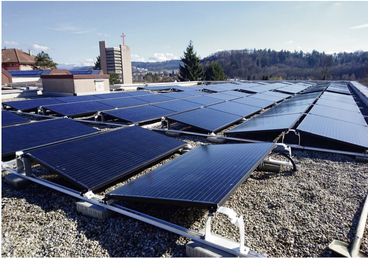
Die Fotovoltaikanlage auf dem Dach des Ökumenischen Zentrums Ittigen.
